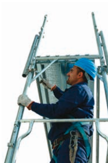
48 • zaciskanie złącza stojaka krańcowego na poziomie 2
